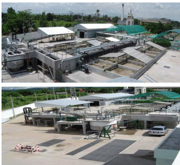
ระบบบำบัดน้ำเสีย เทศบาลเมืองลำพูน
